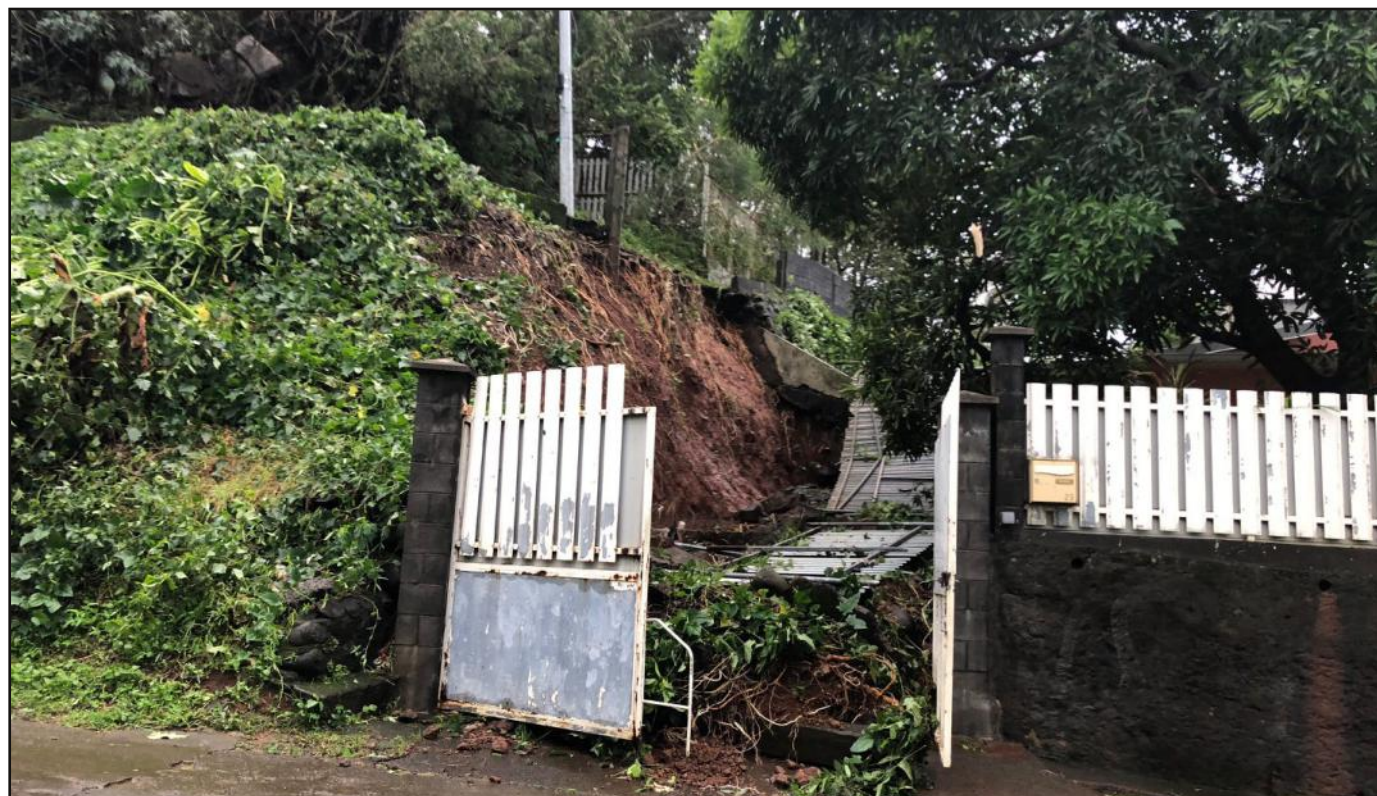
Dégâts causés par Fakir à Sainte-Suzanne.
